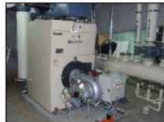
新しい暖房用ボイラー
